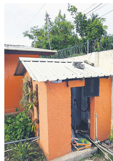
In diesem kleinen Häuschen, auf dem mit einer hohen Mauer und Stacheldraht gesicherten Gelände des Kinderheims Maison des Anges in Tabarre, einem Ausenbezirk der haitianischen Hauptstadt Port-au-Prince, befindet sich der neue Brunnen.
