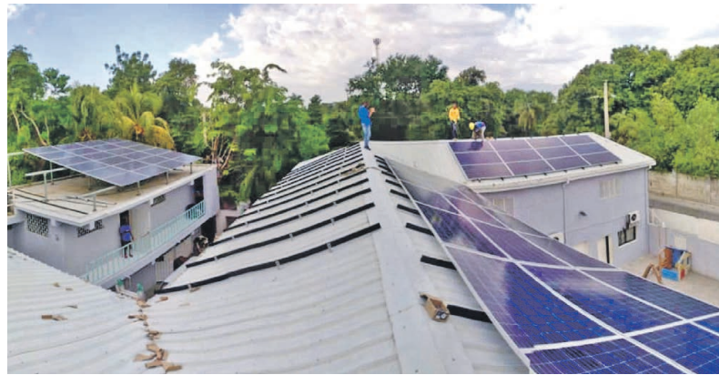
Eine riesige Erleichterung: Durch die Solaranlage bekommt das Kinderheim in Haiti eine stabile Energieversorgung.
